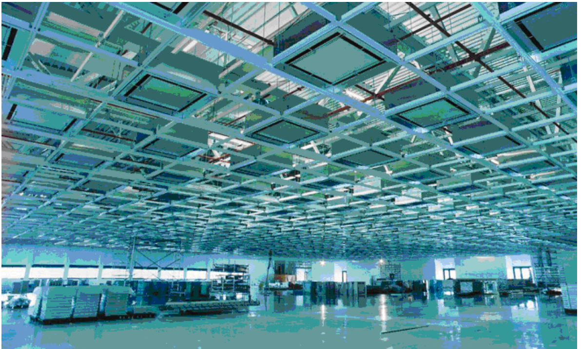
Рис. 2.6. Чистая комната для микрорезонного производства с блоками фильтрующих вентиляторов, установленными в решетке на потолке
